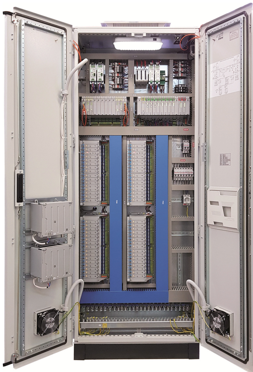
Рис.6. Типовой шкаф УСО на базе контроллера серии МКСО
